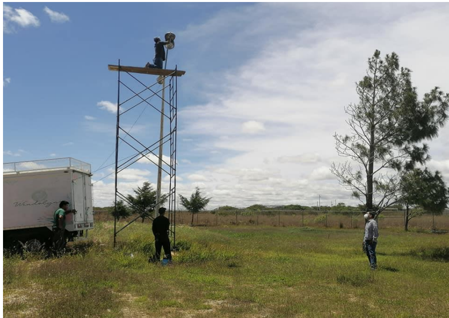
Instalación de 12 nuevas luminarias en estacionamiento y áreas verdes y deportivas, julio de 2020
